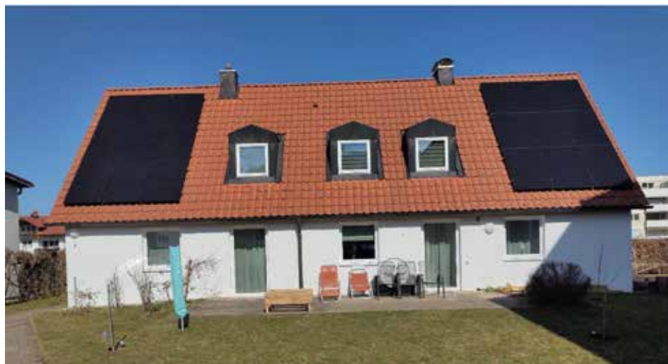
■ Pfarrhaus mit der neuen PV-Anlage
